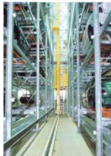
Transelevador guiado por carril y equipado con sistema telescópico, para almacenaje de carrocerías de coches.
