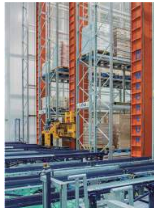
Almacén automático. Cortesía de Mecalux.
