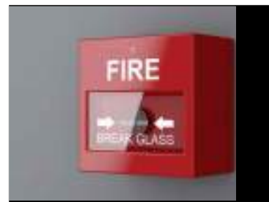
Pulsador en caso de incendio.
