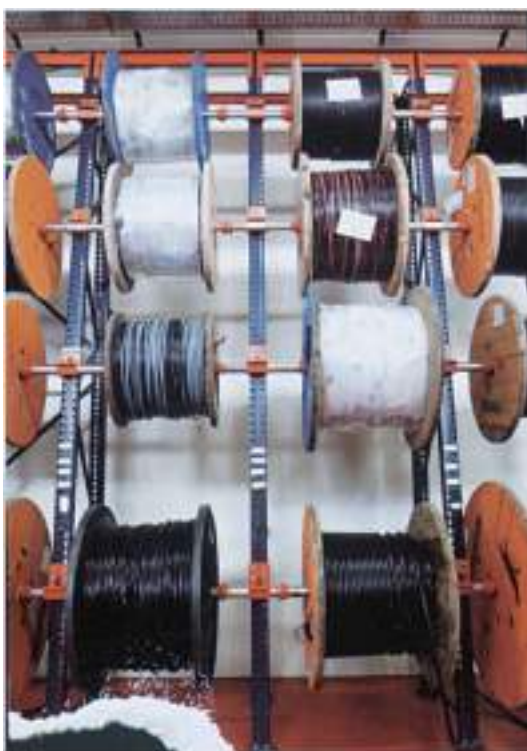
Estanterías especiales para bobinas de cable.
